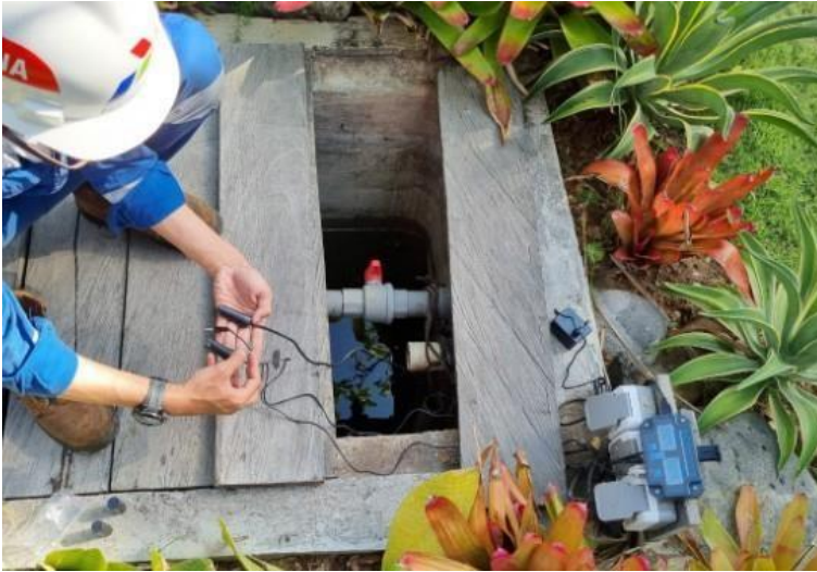
Gambar Pemasangan Alat Monitoring FIPHER
